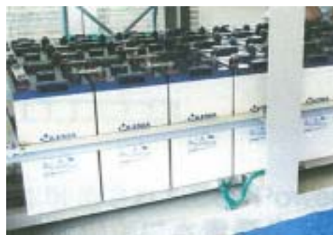
非常用電源設置例
