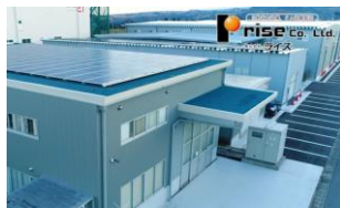
太陽光発電設備（同社工場屋根）
