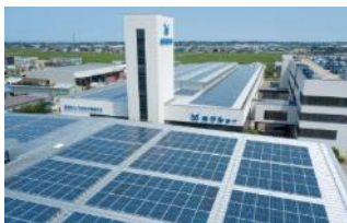
太陽光発電設備（同社白山工場）
