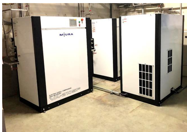
導入した熱回収コンプレッサー
