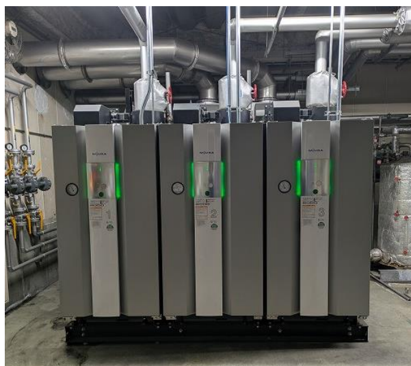
導入した LPG ボイラー
