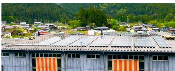
導入した太陽光パネル
