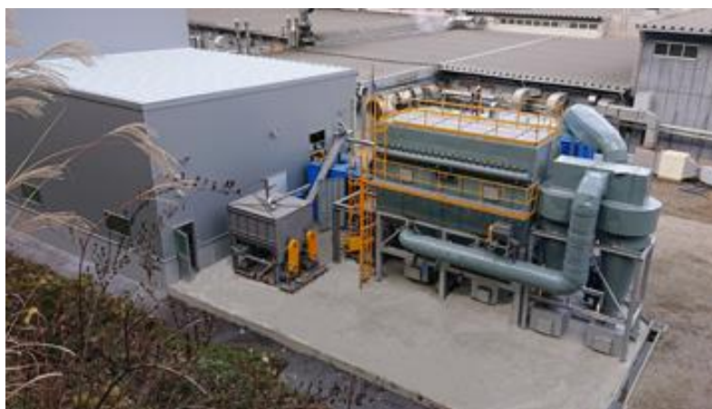
RPF ボイラー (3t/h)
