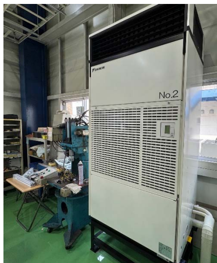
導入した空調設備
