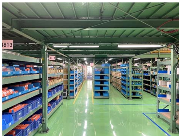
LED 照明を導入した作業空間
