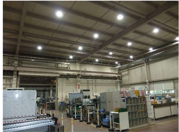
加工ヤードの LED 照明
