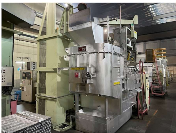
更新したガス燃焼式溶解保持炉 No.5 号機
