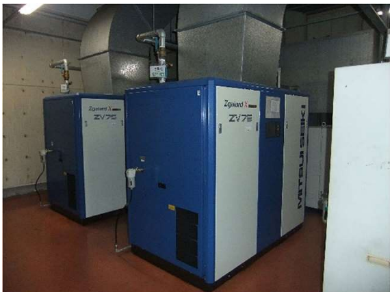
75kW スクリューコンプレッサ 6, 7 号機
