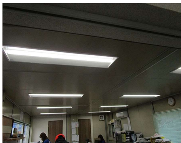
事務所の LED 照明
