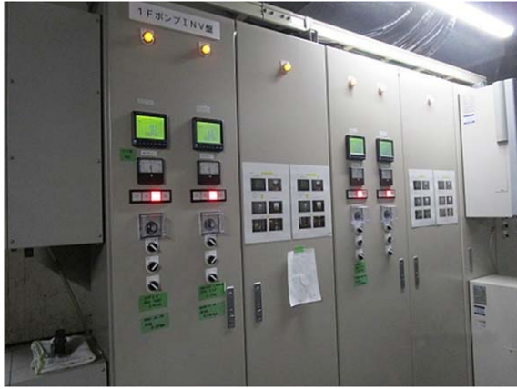
インバータ制御盤
