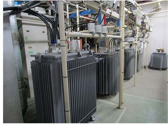
変圧器（手前が新設、奥の2台が既設）
