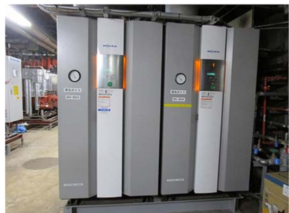
新設の 2t/h ボイラ 2 基
