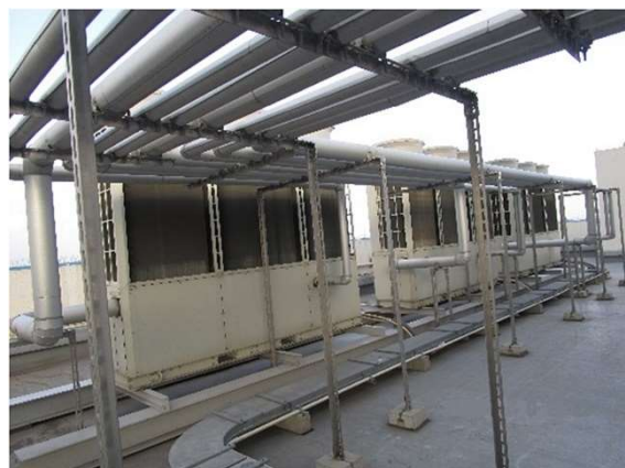
室外機と冷風配管
