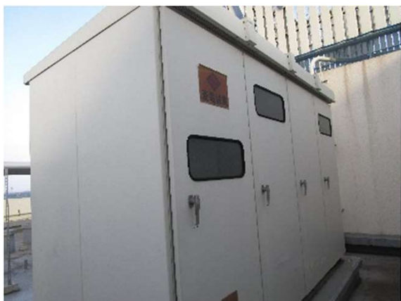
変電設備（変圧器）
