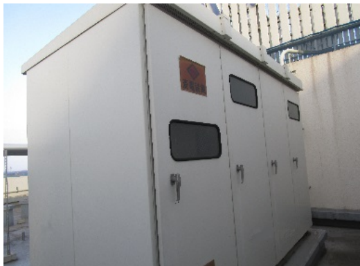
変電設備 (変圧器)
