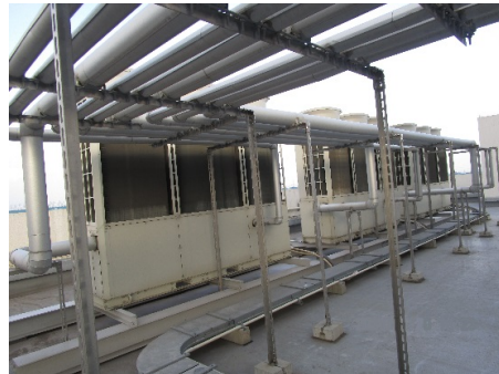
室外機と冷風配管
