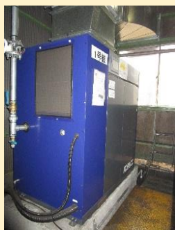
更新したコンプレッサ
