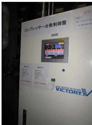
コンプレッサ台数制御盤
