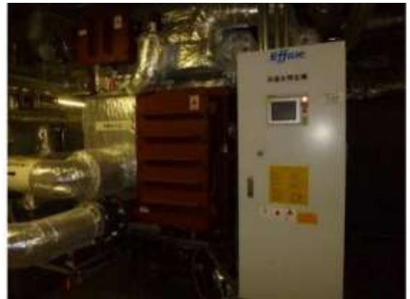
【18】(燃料) 吸収式冷温水発生機(L) 天祥棟 対前年 36.8%
