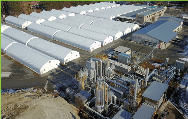
木質バイオマス熱供給設備
