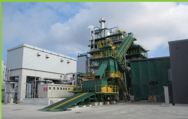
バイオマス発電所写真（BPS大東）
