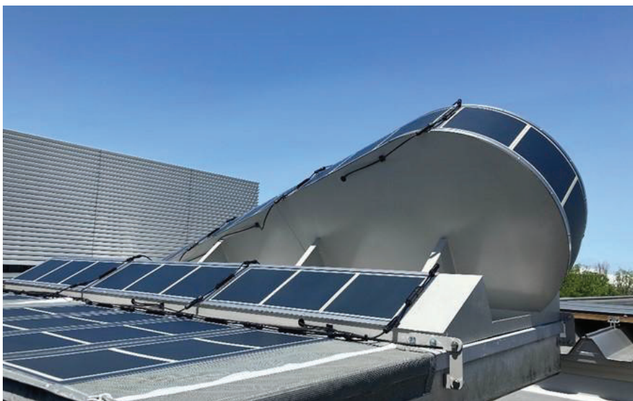
大林組技術研究所での設置状況
