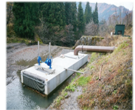
小水力発電施設
