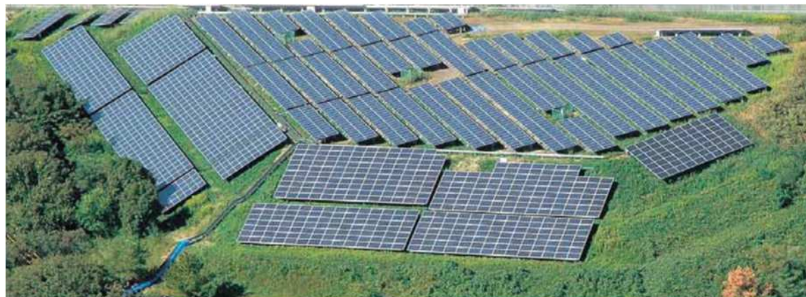
大清水処分場に設置した太陽光発電システム(約868kw)
