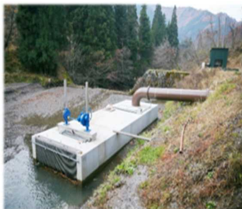
小水力発電施設
