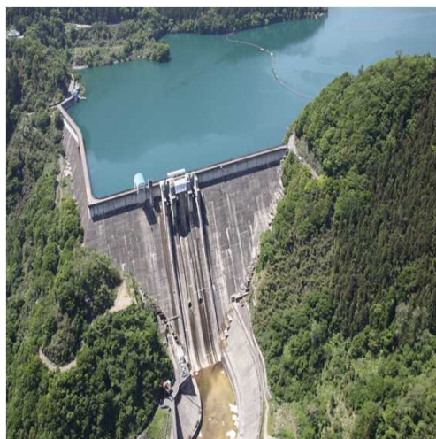
県内の水力発電所
