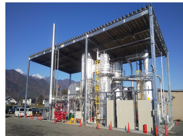
バイオマス燃料製造設備
