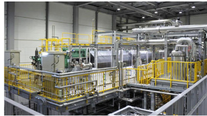
10MWの水電解装置
