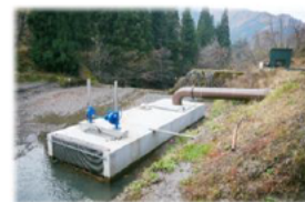
小水力発電施設
