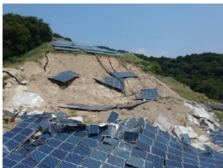
土砂崩れで生じた崩落
