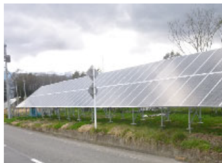
柵塀の設置されない設備
