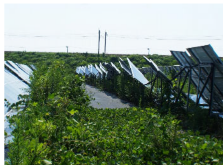
不十分な管理で放置されたパネル
