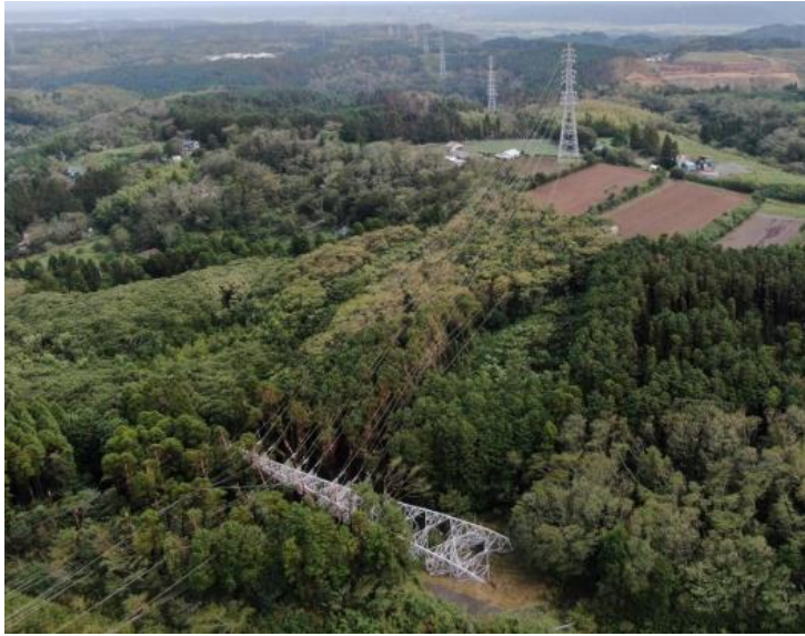
鉄塔設備の倒壊（君津市）
