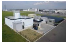
貨物地区水素充填所
