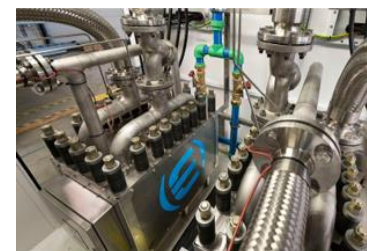
水素製造装置
