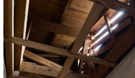
被災した作業部屋の屋根裏
