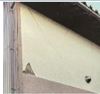
被災した外壁
