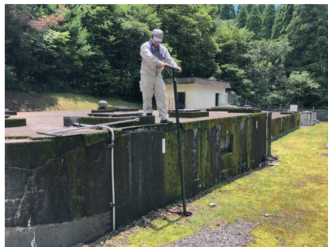
ポンプの正常稼働や水位の点検が 欠かせない配水施設
