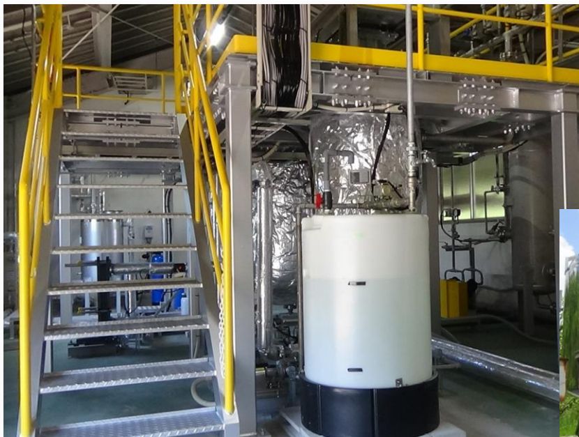
▲ 水素製造装置
