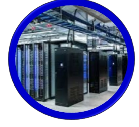
データセンター
