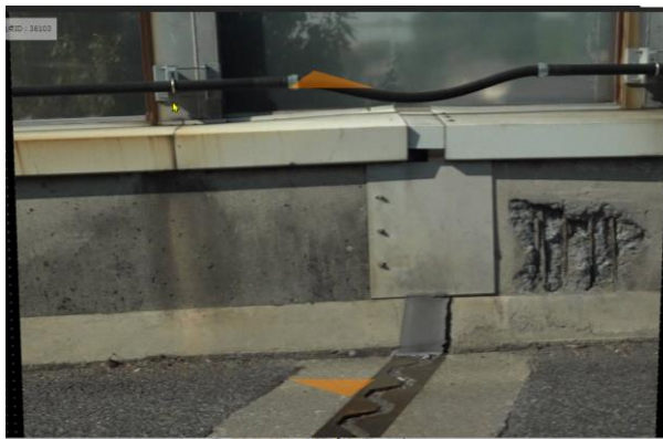
ジョイント付近の露筋
