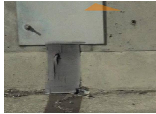
ジョイントゴム亀裂
