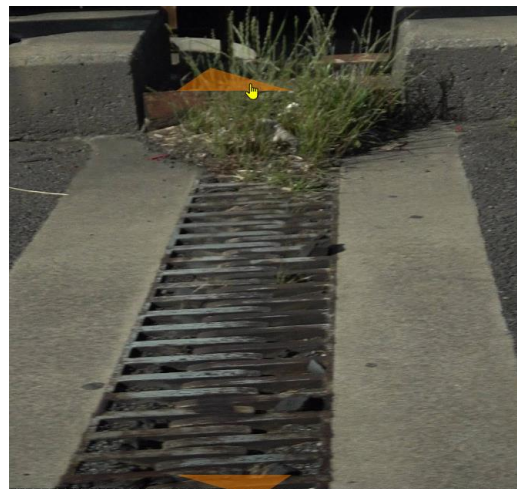
ジョイント雑草・ゴム劣化
