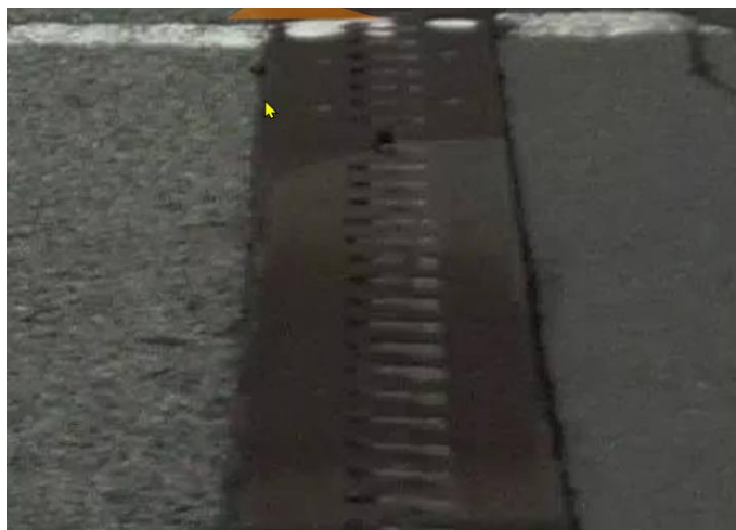
ジョイント段差
