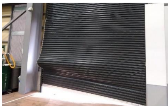
シャッターにゆがみが発生
