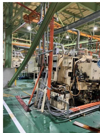
鉄骨のゆがみ
