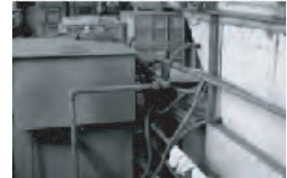
蒸留器の温度、配管を変え、廃液量を改善
