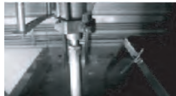
冷却効果改善(装置内部)
